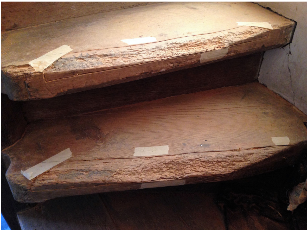
40. De aangetaste delen worden alleen ter plaatse van het loopvlak weg gezaagd.
