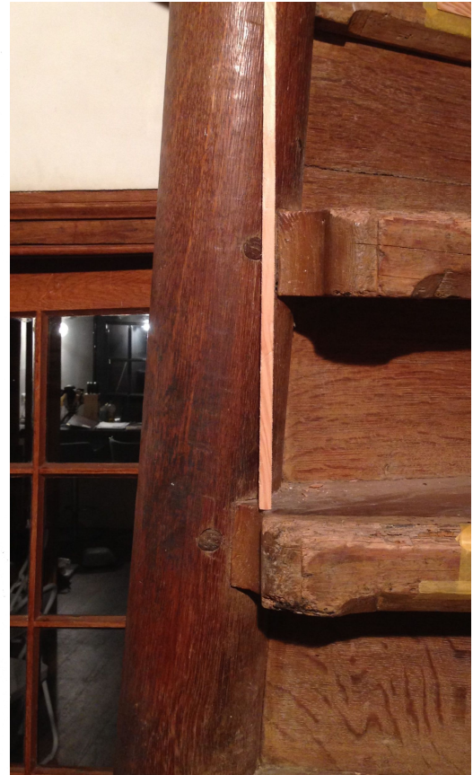
34. De onderzijde van de spil staat scheef, terwijl de verbindingen netjes langs de loodlijn zijn uitgehakt.
