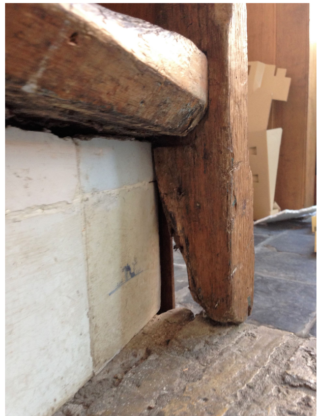
56. De afgebrokkelde voet van de trappaal.
