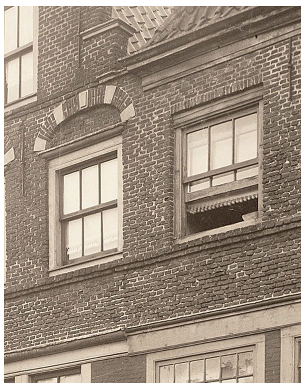
4b. Detail. Het metselwerk vertoont geen bouwnaad tussen beide gevels en de gemetselde lijst onder de raamkozijnen loopt ononderbroken door.
