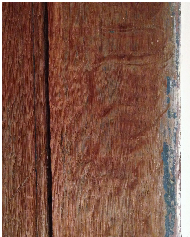
35. Langs de randen zijn nog de resten van de verwijderde verflagen te vinden. De fraaie tekening van de spiegels in het oude eikenhout is hier goed zichtbaar.
