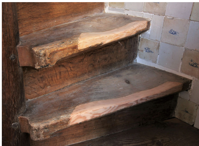
42. In de ingeboete stukken wordt het slijtpatroon van de oude trede doorgezet, maar nu zonder de sterke afschuining aan de voorkant.
