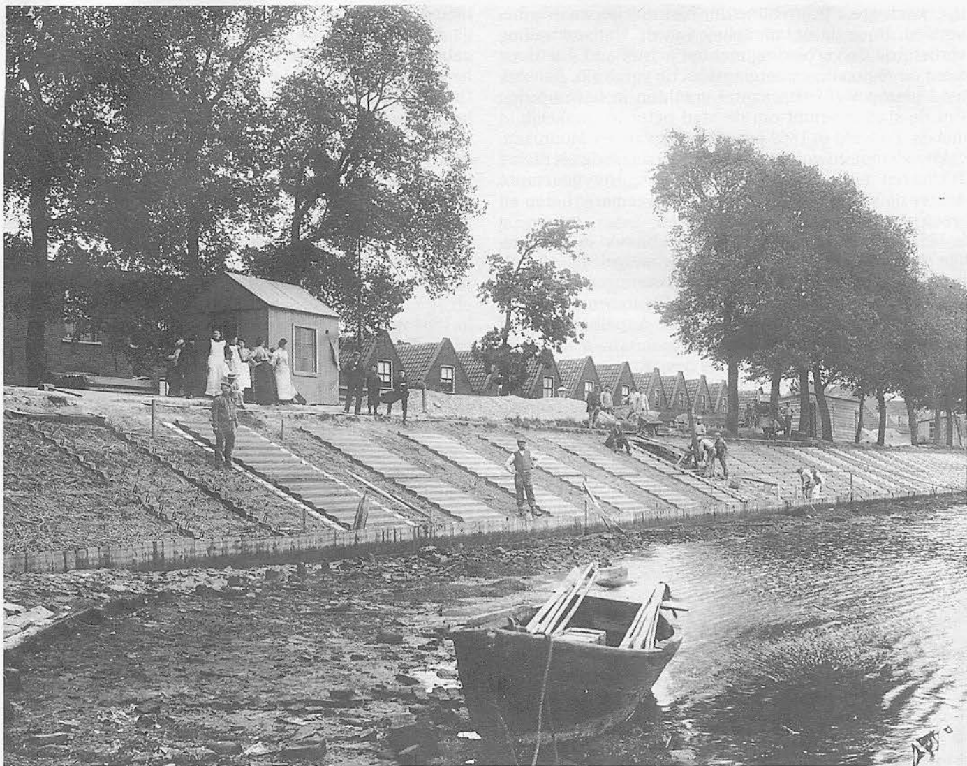
Deze foto heeft onze vereniging cadeau gekregen van "Oud Enkhuizen". Zij geeft de herstelwerkzaamheden weer aan de dijk langs Achter op 't Zand in het jaar 1916. In dat jaar was er nog sprake van eb en vloed op het IJsselmeer en was de dijk tengevolge van een storm beschadigd.
