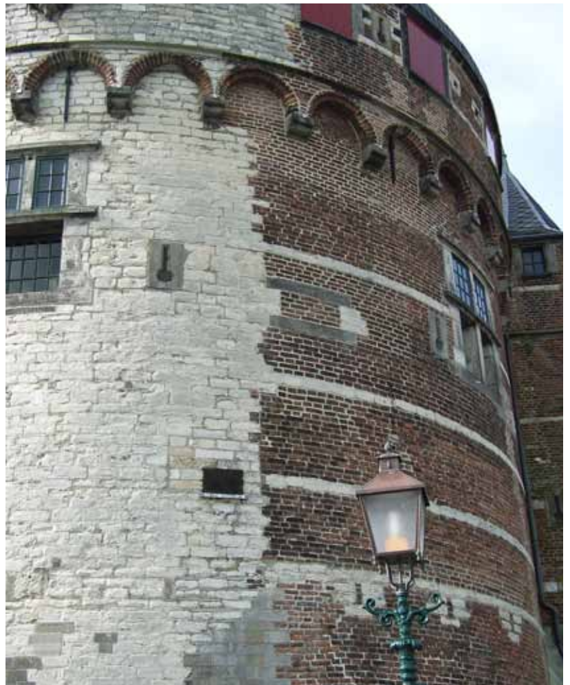
Het rafelig verlopende contact tussen kalksteen en baksteen aan de zeezijde van de Hoofdtoren
