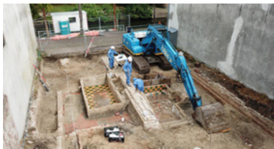
Afb 4 De funderingen en kelders van beide panden waren nog zeer goed bewaard gebleven in de bodem
